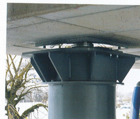
7 Un isolatore sismico e la piastra sovrastante in c.a.
